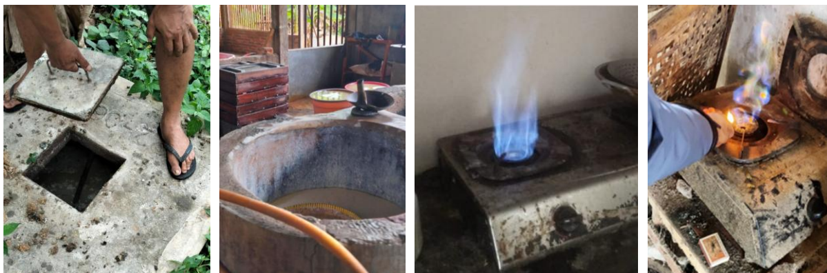
Gambar 3. Instalasi dari digester disalurkan untuk memasak di dapur .
