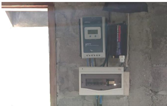
Gambar 4. Komponen sistem panel surya (power inverter, baterai, dan MCB)
