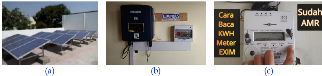
Gambar 2. Perangkat utama PLTS Atap, mulai dari (a) peletakan dan instalasi rangka panel surya di atap jenis dak; (b) instalasi inverter; dan (c) instalasi kWh meter ekspor-impor dalam kondisi automatic meter reading (AMR)
