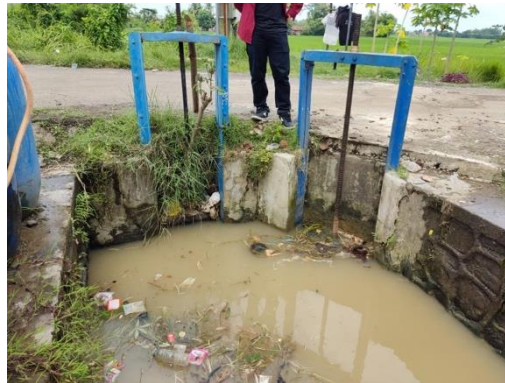
Gambar 2. Kondisi pintu air irigasi yang rusak
